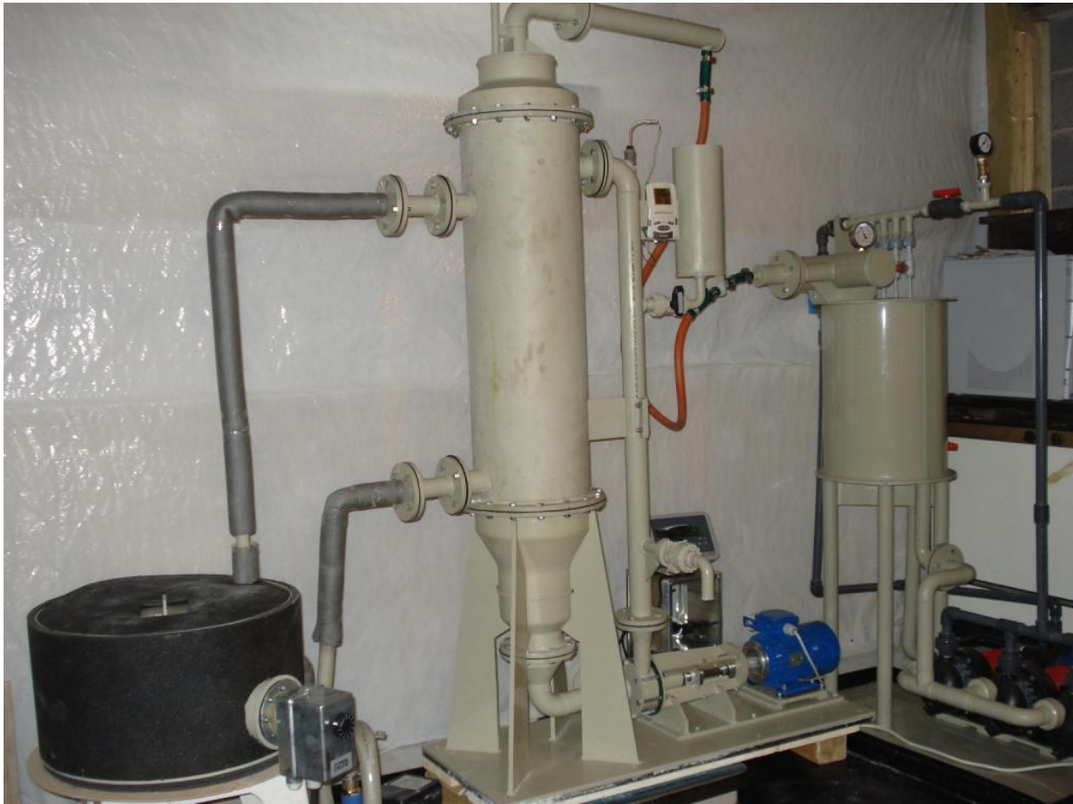
Kiteytyslaitteisto. Keskellä kiteytin, vasemmalla lämpöputkistossa kiertävän veden lämmitys, oikealla tyhjiöjärjestelmä.
