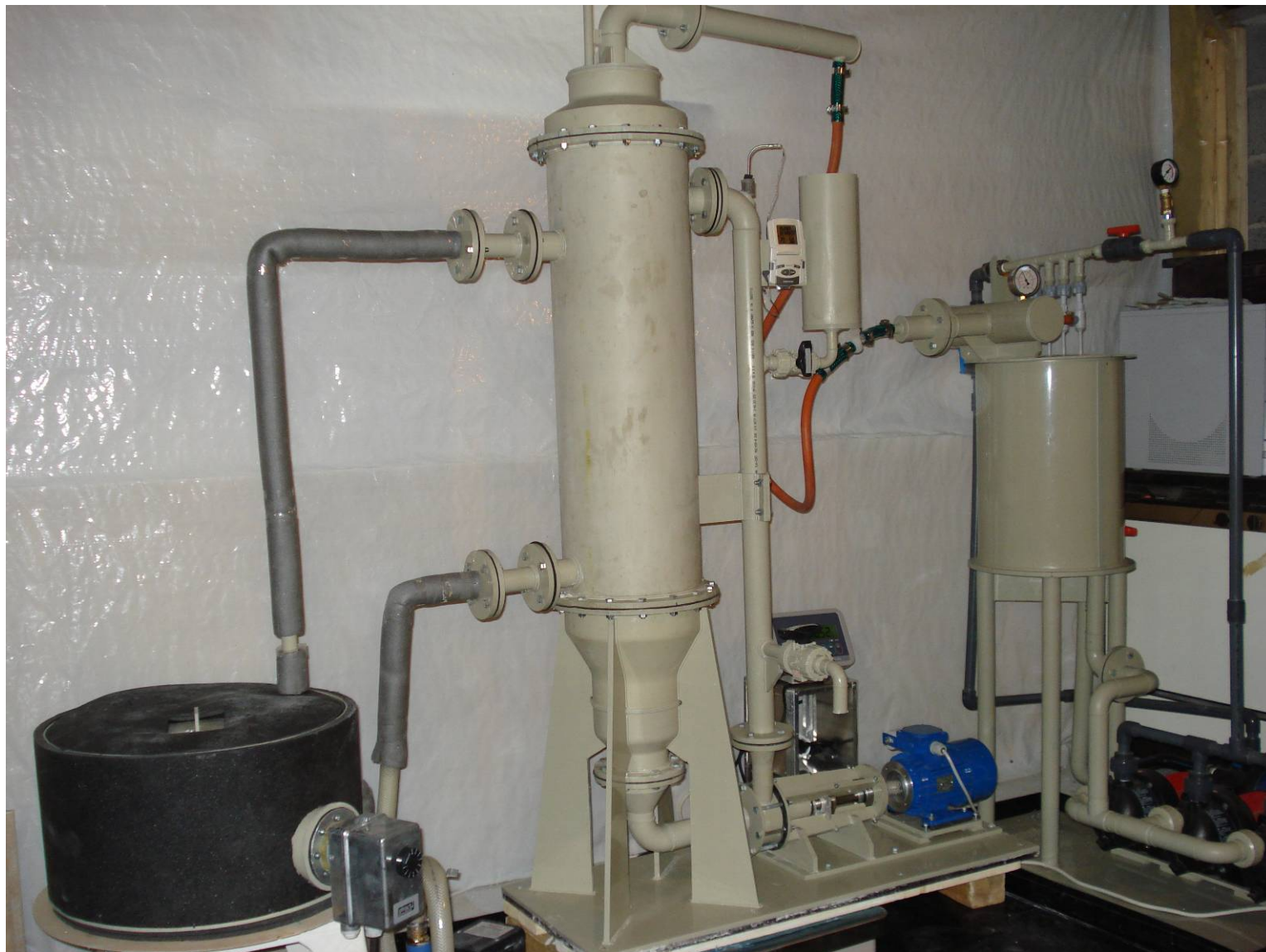
Kokonaiskuva kiteytyslaitteistosta. Keskellä haihdutin, vasemmalla lämmityskierto, oikealla tyhjiöasema.
